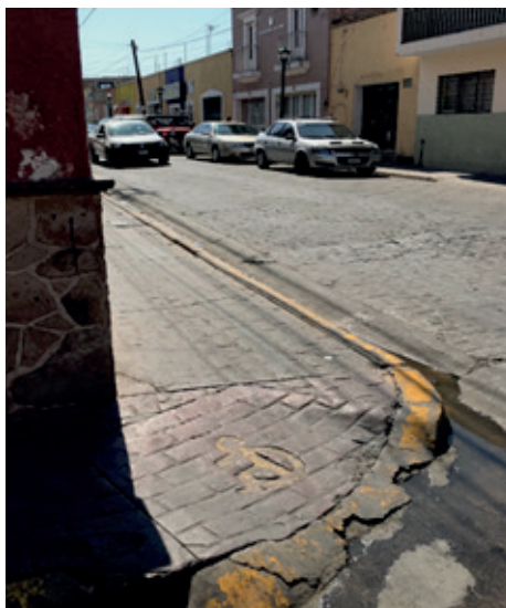
Figuras 10 y 11. Rampas de acceso en mal estado que complica el acceso en silla de ruedas en la calle Morelos del centro urbano de Tonalá
